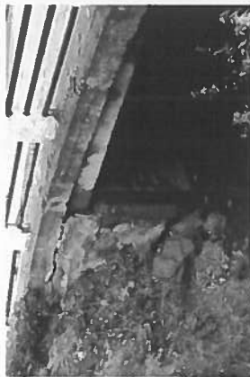
Pohled na povodňové čelo nosné konstrukce. Palmná je zatlačení na úložný práh a nosnou konstrukci, trhliny v křídle a sloup opěvnění svahového kužele.
