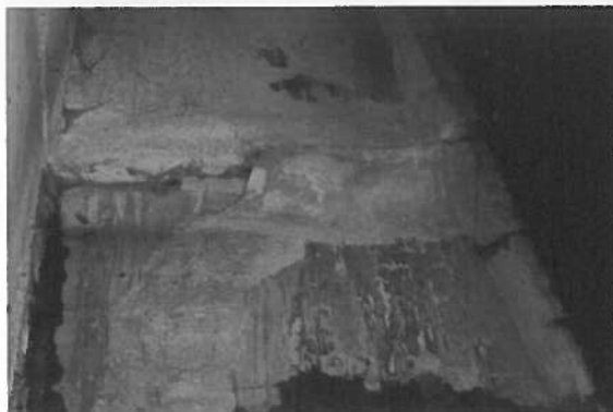
Napojení spodní stavby prvního a druhého rozšíření mostu. Rozsvětlá trhlina mezi jednotlivými částmi spodní stavby a zalévání na úložný práh druhého rozšíření mostu.
