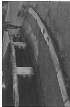
Pohled na chodník na povodňové straně mostu. Palmná je degradace betonového zábradlí mostu, rozpad chodníku a pokles obrubníku a vozovky na mostě (v místě poklesu jsou kaluže vody).
