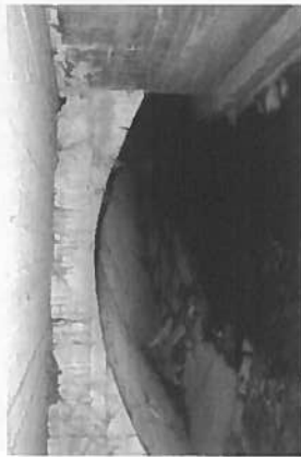
Pohled na rozhraní mezi původní klenbovou konstrukcí a pozdějším monolitickým rozšířením mostu (č.1). V pozadí palmná degradace betonu v místě sacího vpustí kanalizace.
