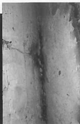
Trhlina v původní klenbové části mostu s lokálním prusákem v místě paty klenby.
