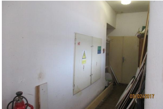
Foto : Umístění el. rozvaděče HR přístavku a elektroměrového rozvaděče ER na chodbě za trafostanicí
