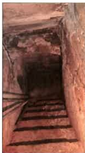
Areál Galček - zatopený sklep bývalé galvanovny
