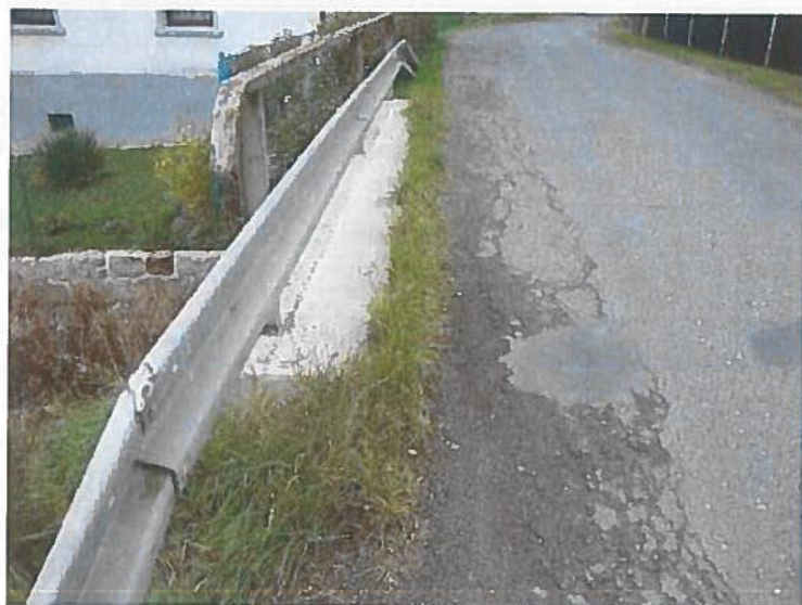
Znečištěná pravá krajnice a poruchy krytu komunikace
