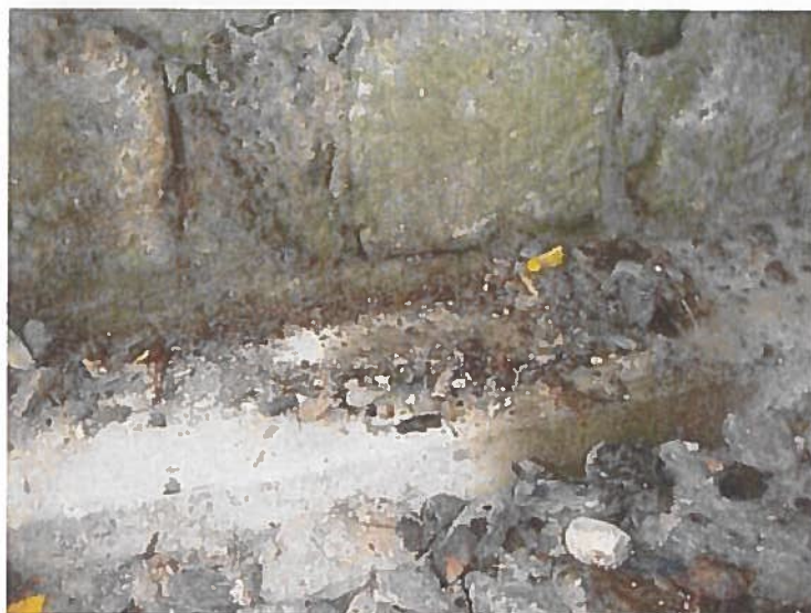
Vypadané spárování v OP1
