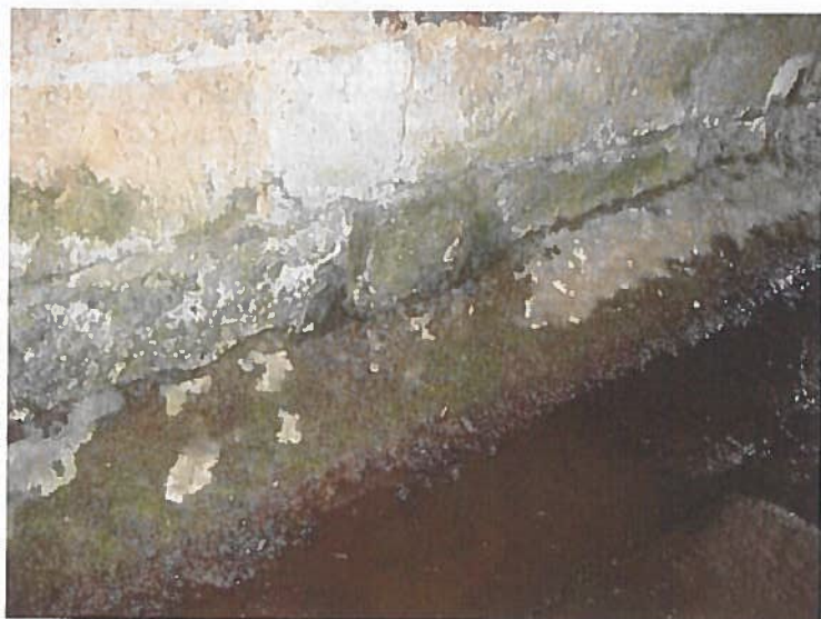
Degradující betonové klíny podél opěr
