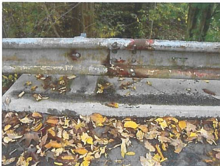
Koroze svodnic na levé straně mostu
