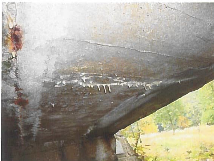
Zatékání mezi 1. a 2. ocelovým nosníkem vpravo
