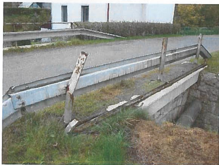
Poškozený zadržný systém
