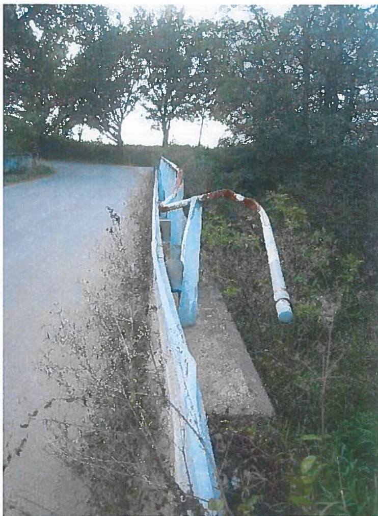
Stav zábradelního svodidla.
