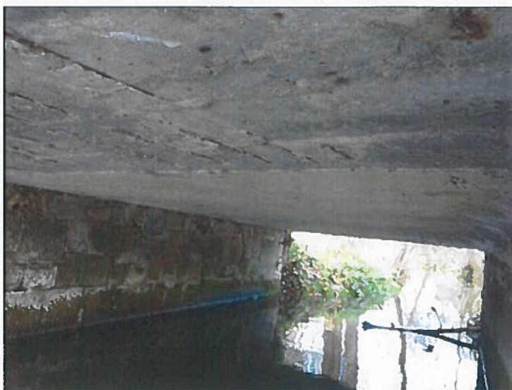
Pohled na OP1, lokálně vypadlé spárování
