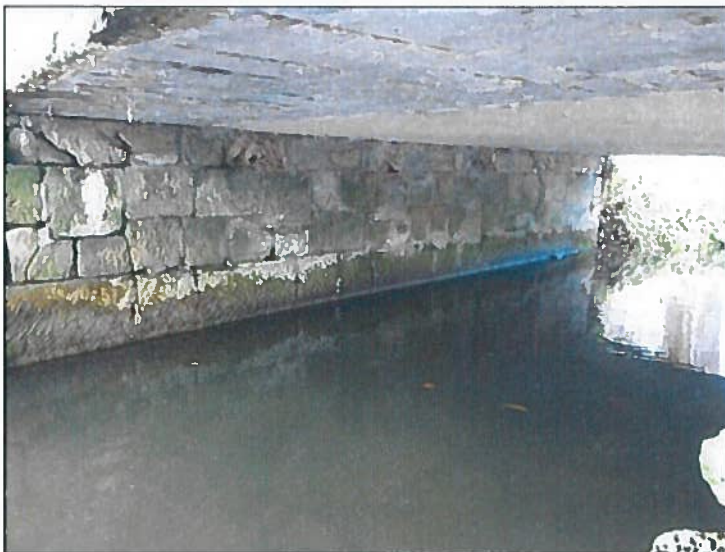
Pohled na OP3, trhliny a rozvolnění opěry
