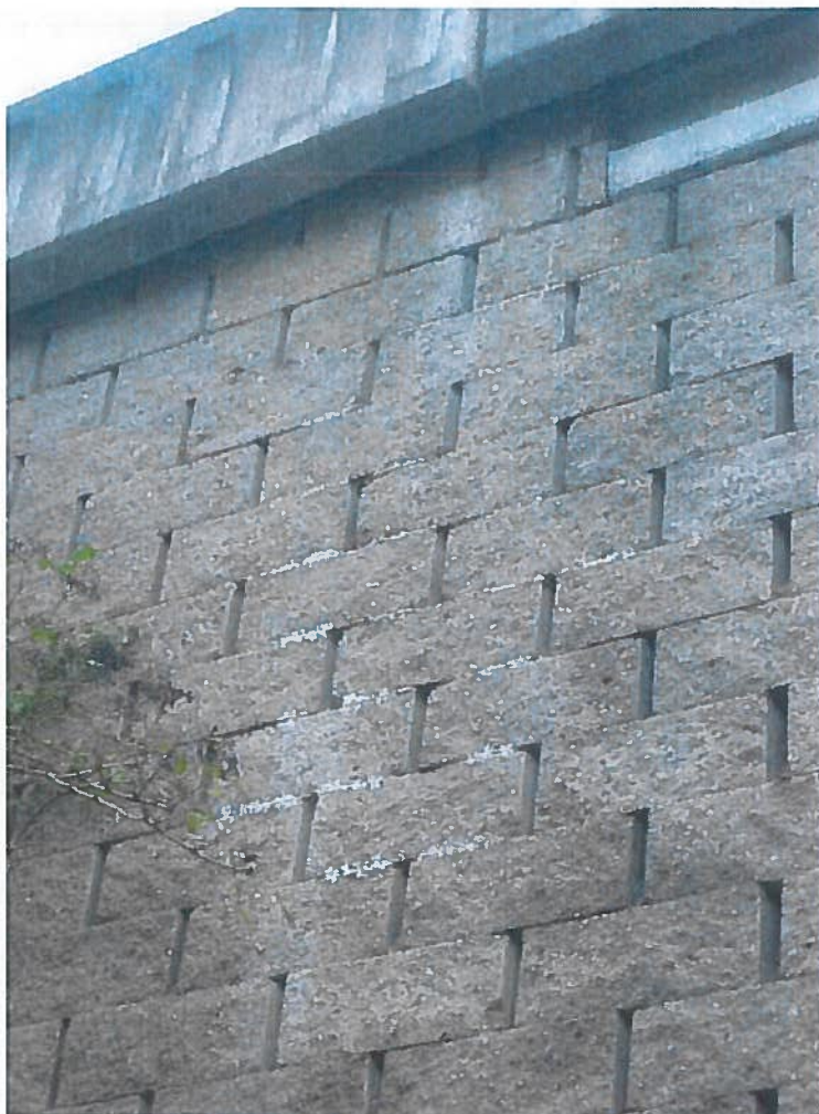
Dtto - zatékání a výluhy
