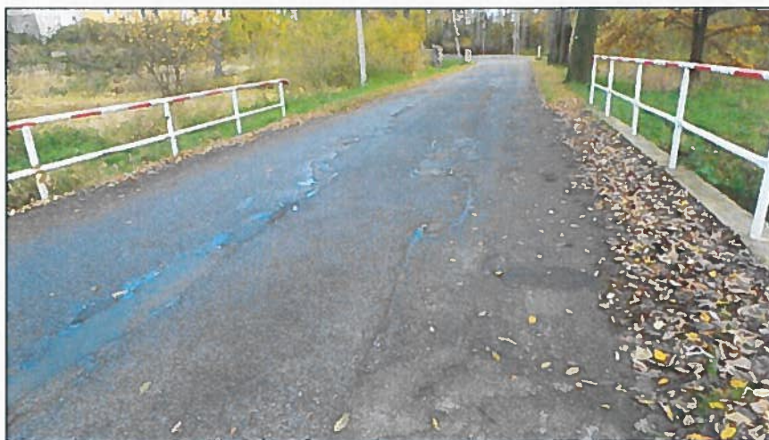
Trhliny ve vozovce
