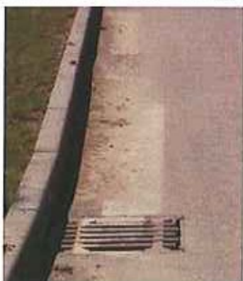
Detail vpustě dešťové kanalizace a znečištění podél obrubníků
