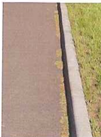
nečistoty podél krajnice
