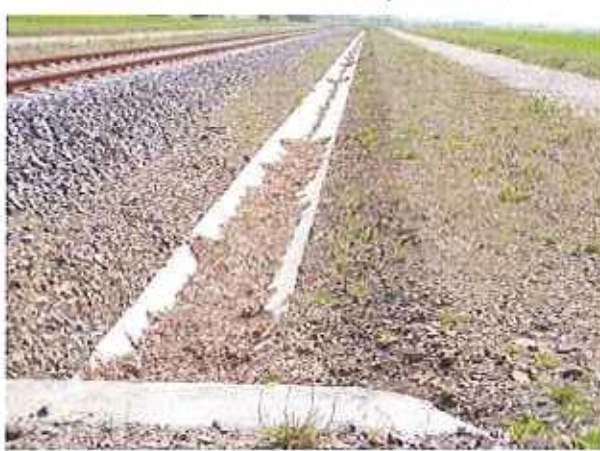
Detail znečištění odvodňovacích žlabů
