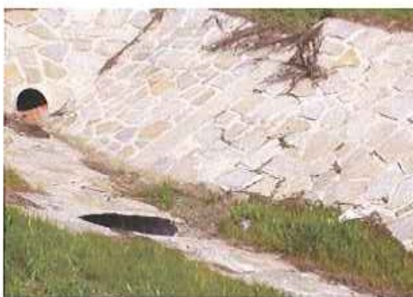
Detail nedostatečně udržovaného propustku
