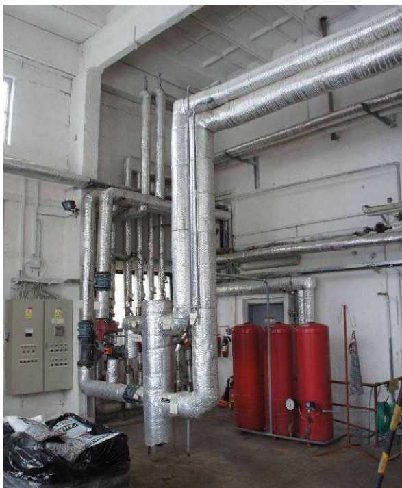
Obrázek 3: Hlavní rozvody v kotelně.
