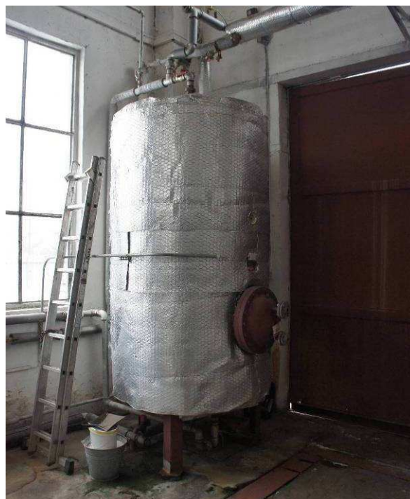
Obrázek 4: Izolovaný zásobník teplé vody.
