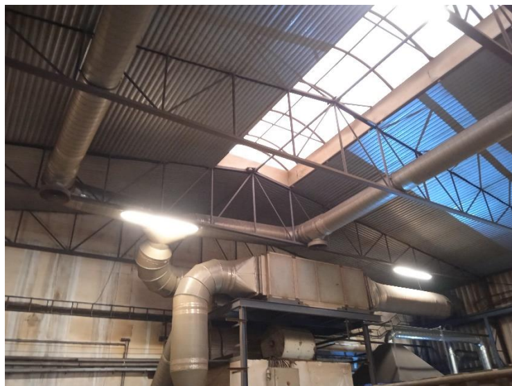
Příloha č.3 : Fotografie uspořádání stávající vzduchotechniky:
