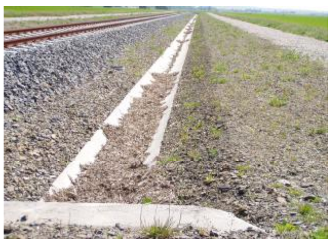
Detail znečištění odvodňovacích žlabů
