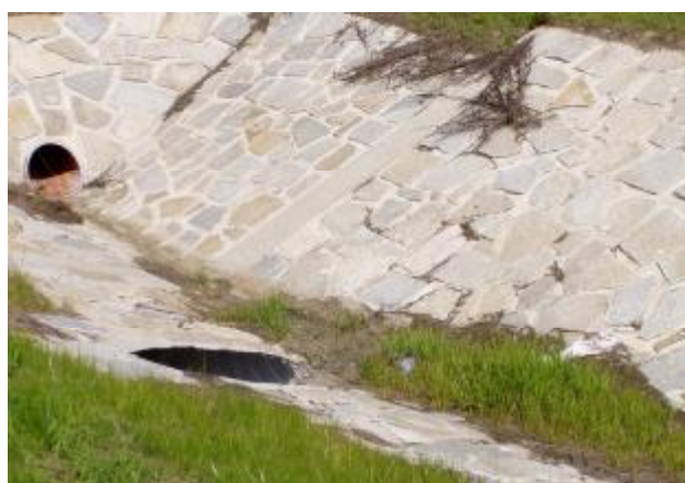
Detail nedostatečně udržovaného propustku
