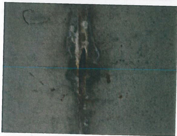
Detail výluhů ve spáře mezi nosníky
