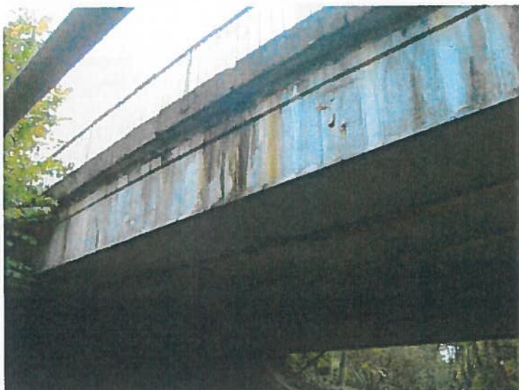
Zatékání na bok NK z pod římky
