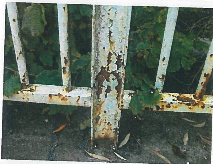
Detail koroze zábradlí
