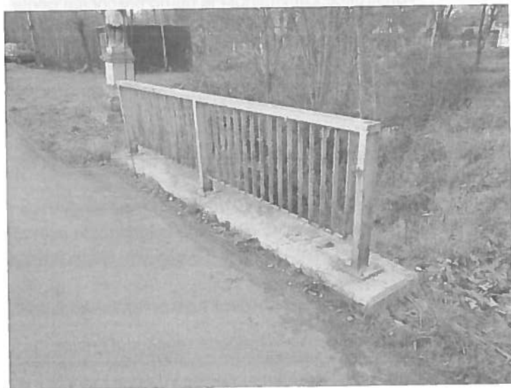
Uspořádání na výtokové římse
