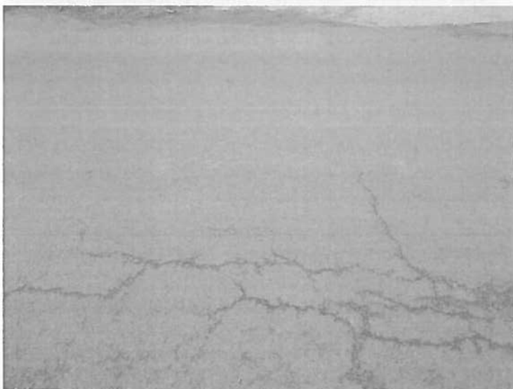
Síť trhlin ve vtokovém pravobřežním prostoru vozovky
