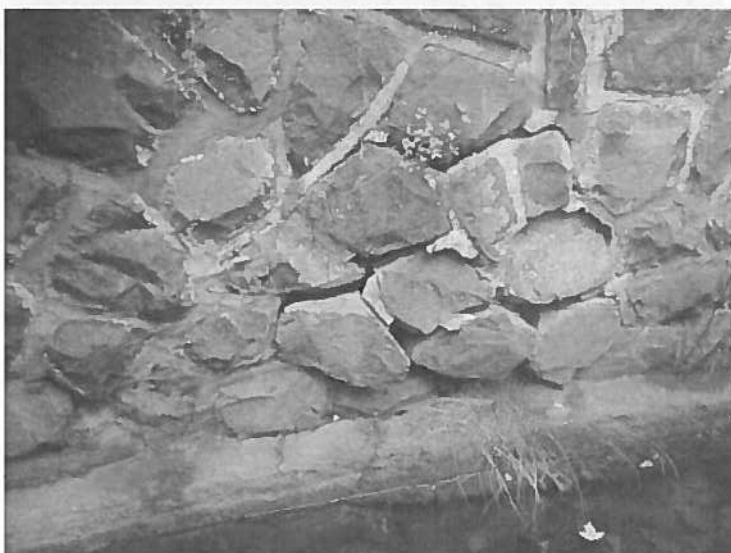
Poruchy navazující zdiva na vtoku
