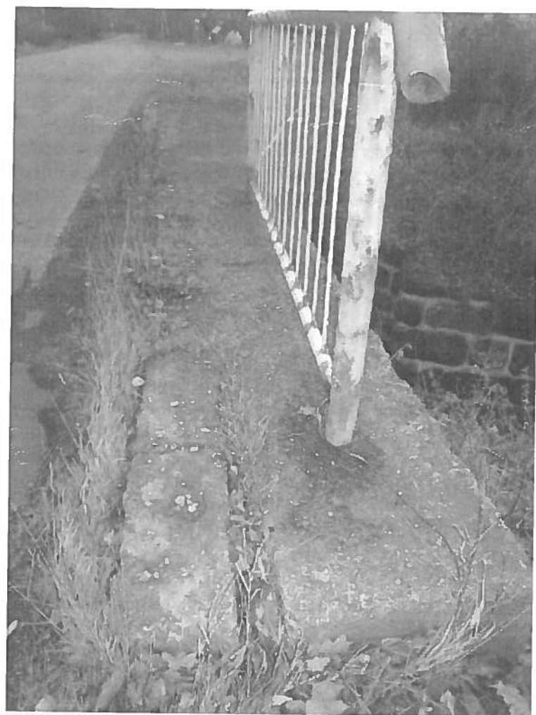
Koroze zábradlí, vegetace, uvolněný obrubník
