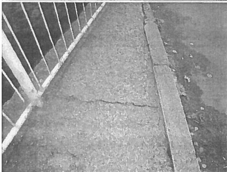
Beton řims - trhlina
