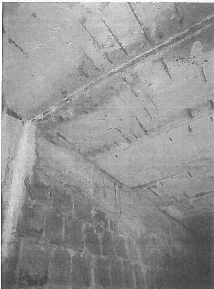
zatékání do spáry NK, koroze výztuže NK
