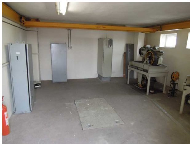
Strojovna výtahu na střeše
